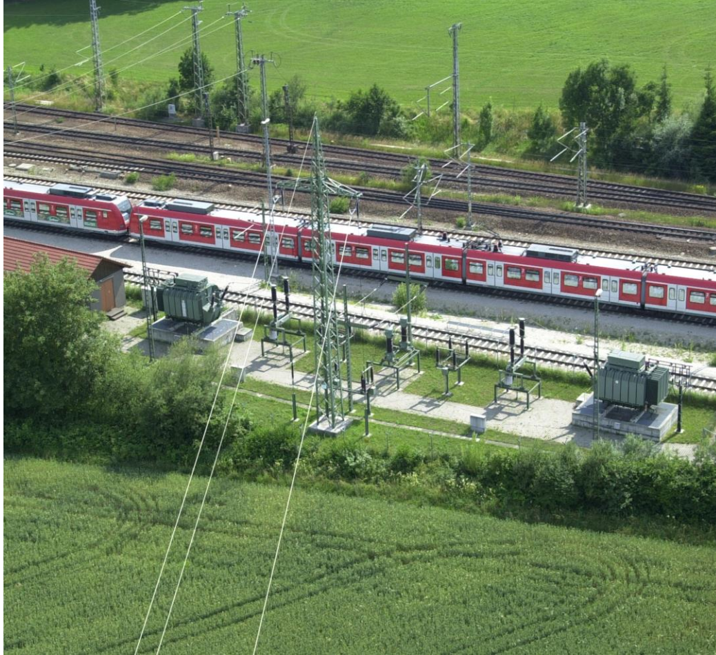
Bildquelle: Bestehendes Unterwerk von DB Energie GmbH
